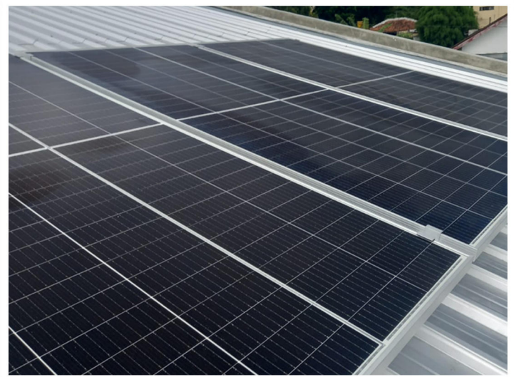
@ Klaten - 5 kW ONGRID
