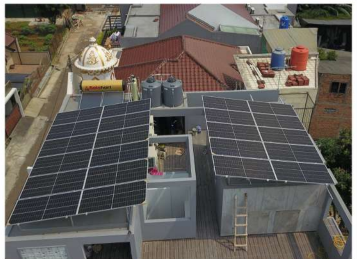
@ Bekasi - 15 kW On Grid
